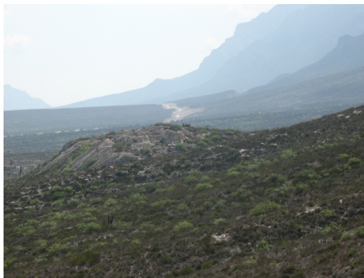
F.28. Km 56+050 Vista hacia Monterrey, lomerío donde se observa en segundo término los trabajos de desmonte y despalme del tramo en construcción de la autopista Saltillo-Monterrey, correspondiente al estado de Nuevo León
