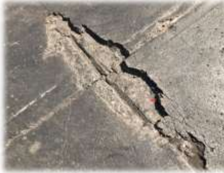
Grietas en banquetas
