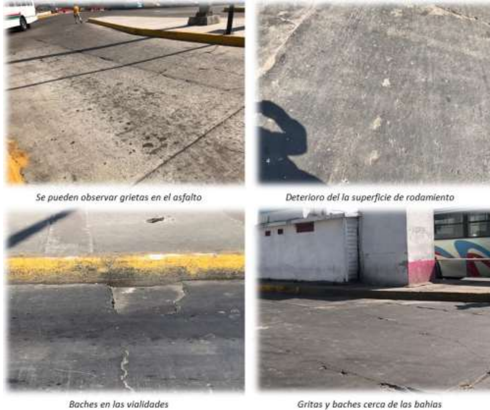
Figura 16 Estado actual del asfalto de las vialidades al interior del CETRAM
