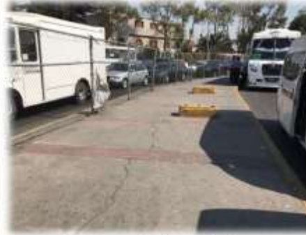
Banquetas manchadas y agrietadas
