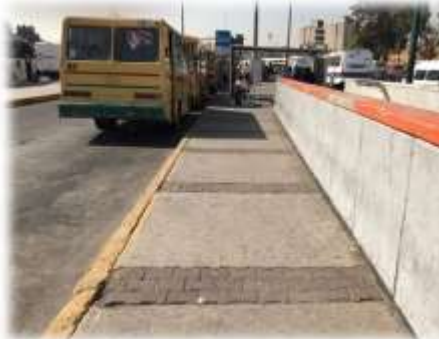
Guarniciones maltratadas y adoquines fuera de nivel
