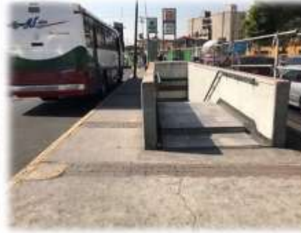
Banqueta fisurada cerca de acceso a metro
